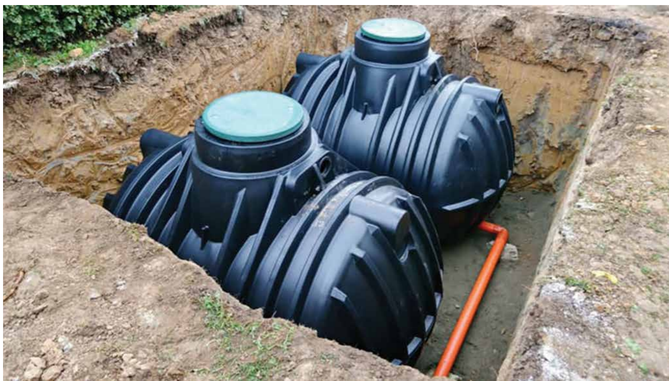
Fig. 14 Rezervoare de stocare a apei. 69
