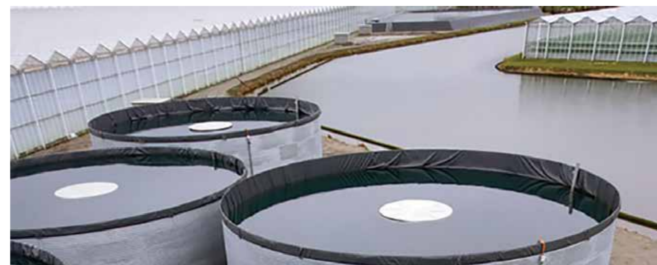
Fig. 15 Rezervoare de colectare a apei de ploaie și a apei de drenaj. 73
